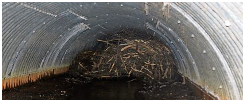
Der gewaltige Biberbau im Bach Böschach unter der A13 in Widnau.
